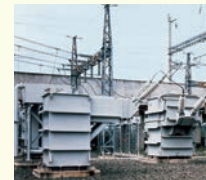
変電所用並列コンデンサ 高圧進相コンデンサ
